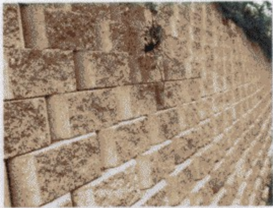
图2-55 天然石砌挡土墙
